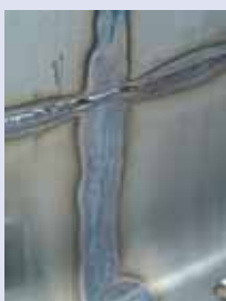
Blålige, anløbne svejsninger fra en tank lavet af 4301. Tabet af korrosionsbestandighed i sådanne anløbninger er alvorligt, og for at stålet skal retablere sin gode korrosionsbestandighed, skal disse anløbninger fjernes. Dette gøres bedst og billigst ved en bejdsning.
